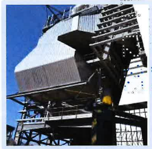
Unité de traitement des fumées
