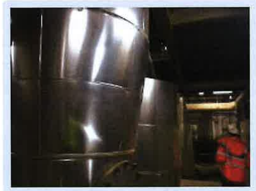
Unité séchage des boues
